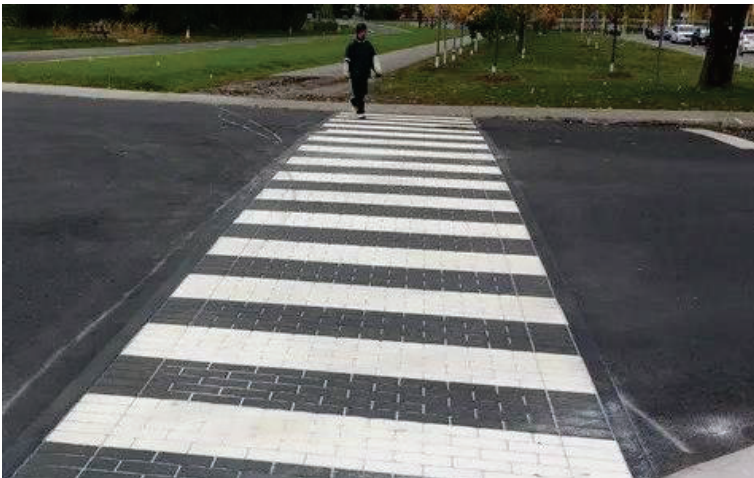
Figure 7-6 Traverse piétonne texturée en thermoplastique
